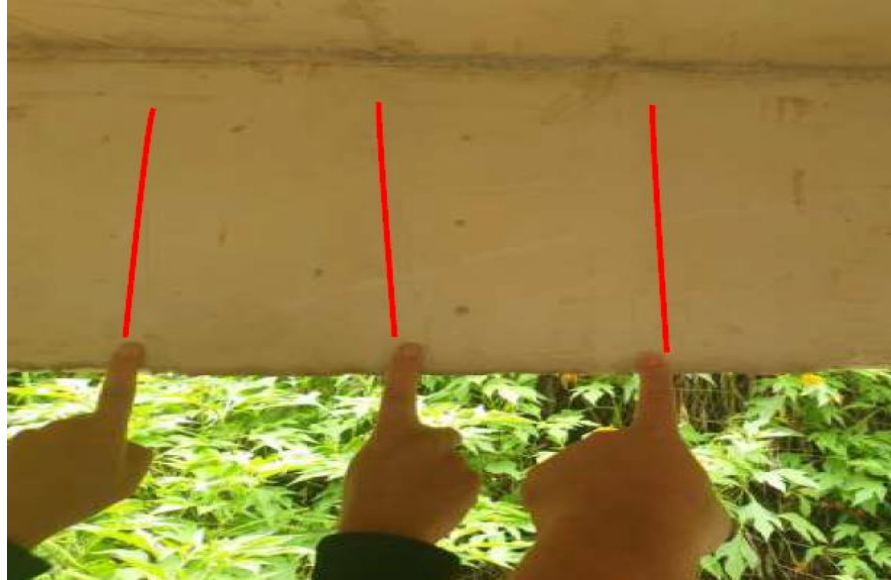
Gambar 8. Retak Bordes Tangga
