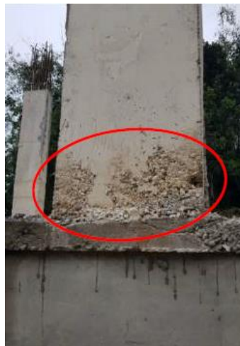
Gambar 9. Segregasi Kolom di Lantai 2
