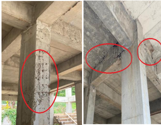
Gambar 6. Segregasi kolom lantai 1 dan kolom lantai 2
